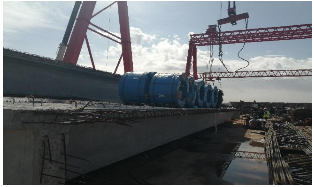
白音察干至永泰公高速公路项目桩基 完整性和单梁荷载试验检测
